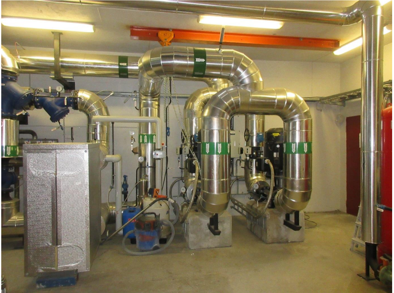
Figur 3. Varmesentral (fjernvarme) Lillehammer sykehus (foto Sykehusbygg)
